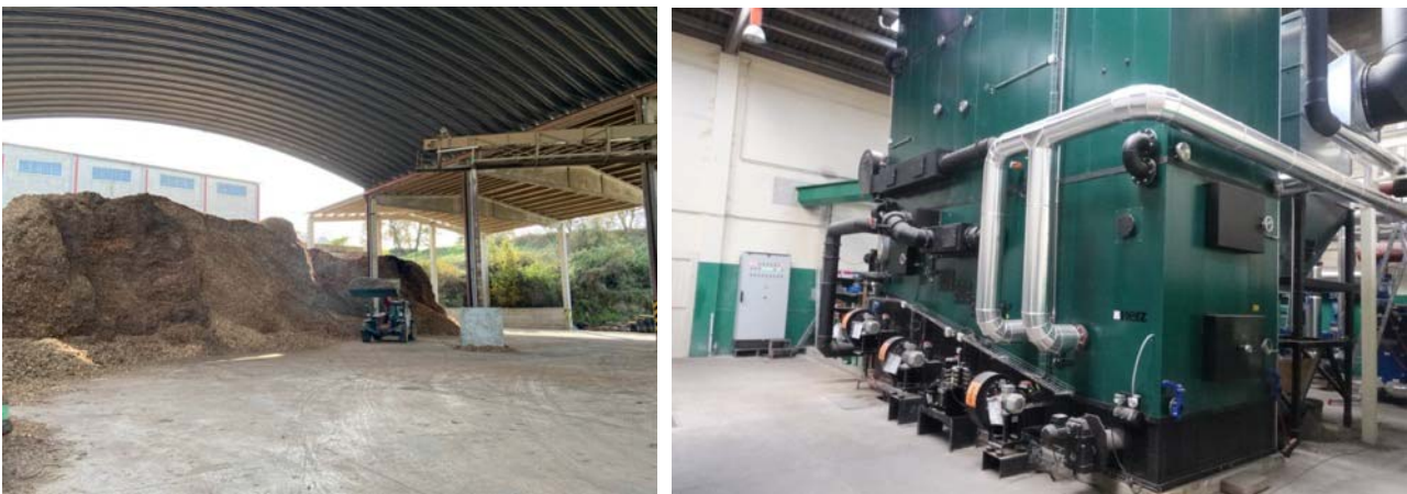
Figura 8: Imatges de la central que alimenta la xarxa de calefacció a Sant Pere de Torelló. Fotos: Griselda Castells
